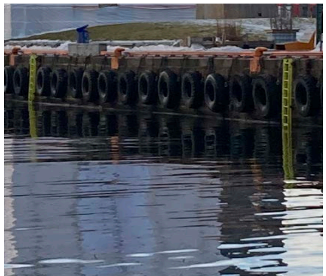
Gul redningsstige montert mellom gummidekk på kaifront. Orange kaifrontlist ovenfor. Foto White arkitekter.
