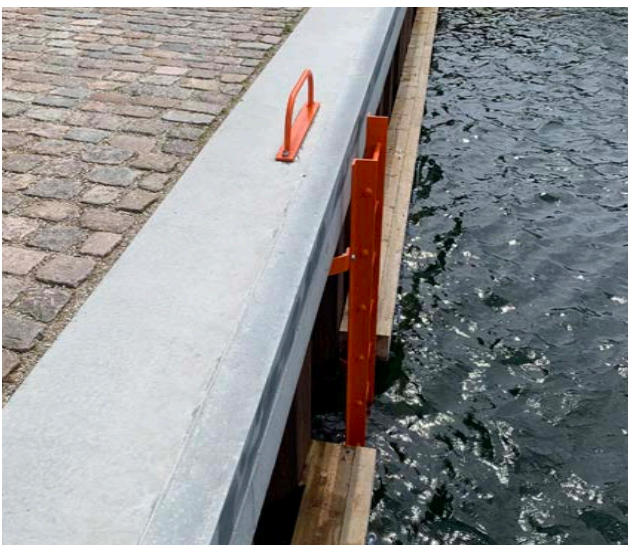
Orange redningsstige montert på kaifronten med gripbøyle ovenfor. Foto White arkitekter.
